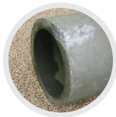
Rohre mit beschädigter Oberfläche
