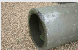
Rohre mit beschädigter Oberfläche.
